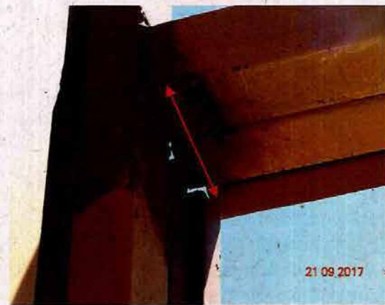
Fotografía N° 2: Aproximación de encuentro piezas metálicas de pilares y vigas de ejes 10a y B2 de la estructura y techumbre.
