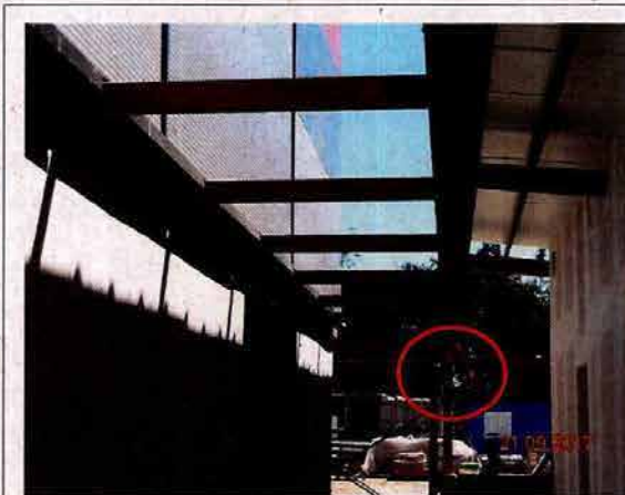
Fotografía N° 1: Ubicación de encuentro piezas metálicas de pilares y vigas de ejes 10 a y B2 de la estructura y techumbre.
