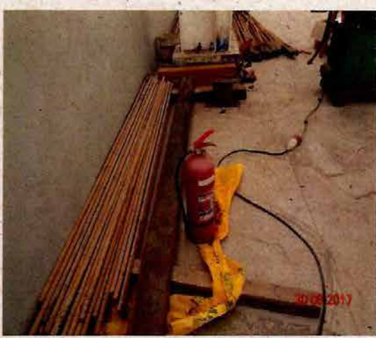
Fotografía N° 24: Extintor ubicado en sector de trabajos de soldadura con fecha vencida, noviembre de 2016.
