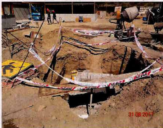
Fotografía N° 27: Protección de excavación para construcción de cámara de inspección no cumple con la normativa.
