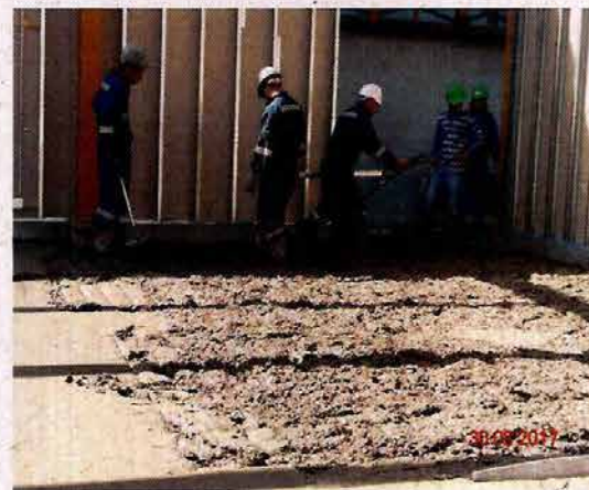
Fotografía N° 30: Algunos trabajadores en la obra no utilizan guantes de seguridad.
