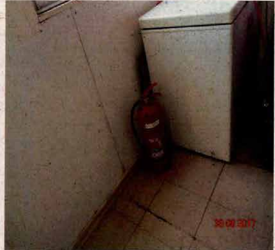
Fotografía N° 22: Extintor sector comedor.
