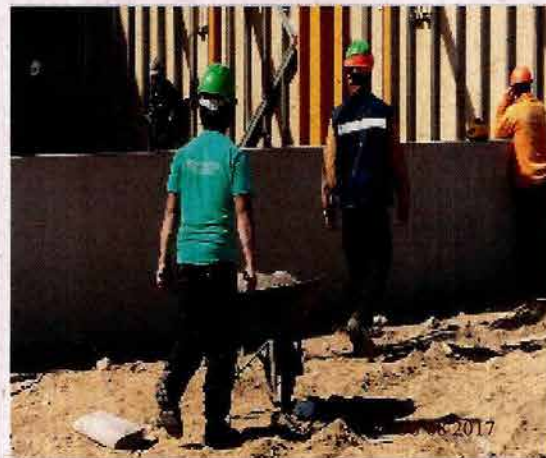
Fotografía N° 28: Algunos trabajadores en la obra no utilizan guantes de seguridad.
