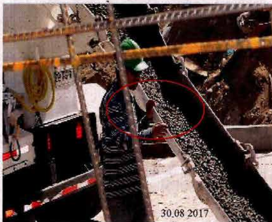
Fotografía N° 29: Algunos trabajadores en la obra no utilizan guantes de seguridad.
