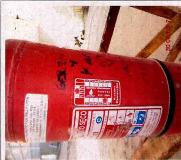
Fotografía N° 25: Extintor ubicado en sector de trabajos de soldadura con fecha vencida, noviembre de 2016.
