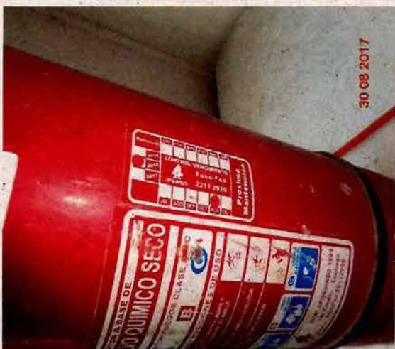
Fotografía N° 23: Extintor sector comedor con fecha vencida, noviembre de 2016.
